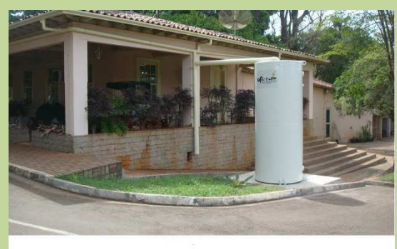
Captação de água- Prédio central
